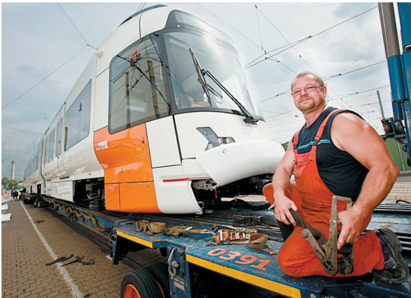
Vorsichtig: Peter Klemenz löst einen der Haltegurte, die den Vamos auf dem Tieflader arretieren. Der Vamos wird mit einer Winde, deren Trosse an der Wagenkupplung befestigt ist, langsam aufs Gleis abgelassen. Links liegen die Verkleidungen für die Drehgestelle. FOTOS: ANDREAS ZOBEL
